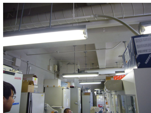
基礎臨床研究棟 4F 実験室 不在時 6灯点灯 退室するときは消灯しましょう
