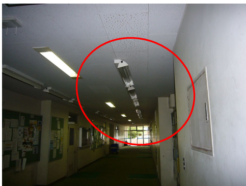
基礎臨床研究棟 1F 通路 掲示板照明消灯 不用事消灯している
