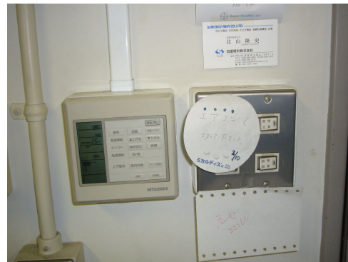
基礎臨床研究棟 1F 会議室 不在時エアコン停止と札を表示し 注意を喚起している
