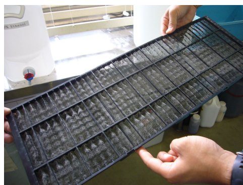
基礎臨床研究棟 5F 実験室 エアコンフィルター清掃状況良好
