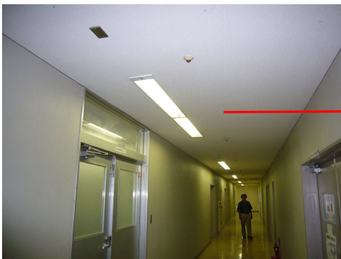
病院 1F 廊下 全照明点灯していた 130Lx
