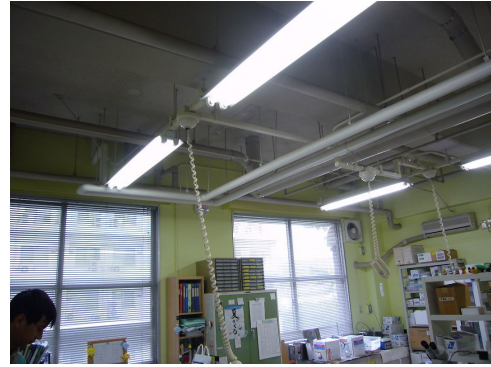
基礎臨床研究棟 3F 実験室 不在時照明点灯、空調23℃設定 退室時消灯し、空調は28℃設定にしましょう
