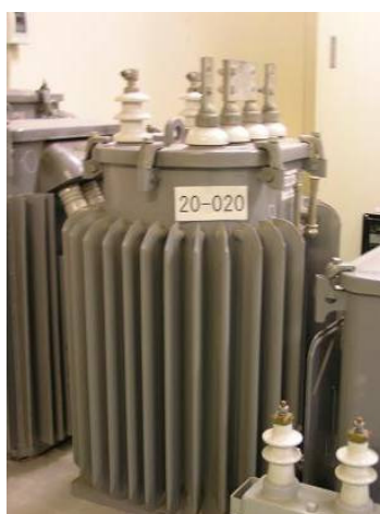
保管中のトランス
