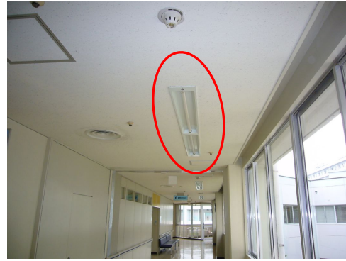
病院 2F廊下 窓側の照明については消灯している
