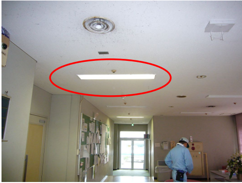
臨床講義棟 入口ホール 照明スイッチで照明を間引き点灯している
