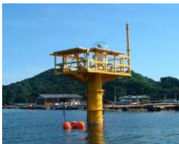
図 1. 高知県浦ノ内湾の設置されたタワー上に配備された太陽光集光装置（ドーム状のもの）およびソーラーパネル（板状のもの）。ここから太陽光エネルギーが光ファイバーにより直接、あるいは発光ダイオード(LED)により海底に導入される。
