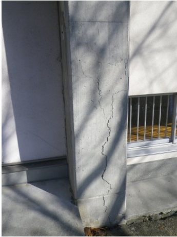
鉄筋コンクリート柱のひび割れ
