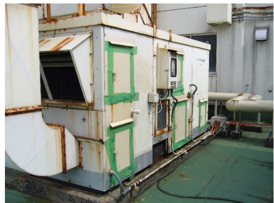
老朽化状況（空調室外機）
